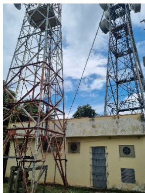
(a) Abrigo de instalação da ERB.
